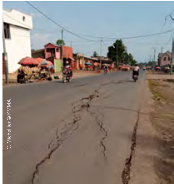
Scheuren die verband houden met dyke-intrusie (magma-injectie).
